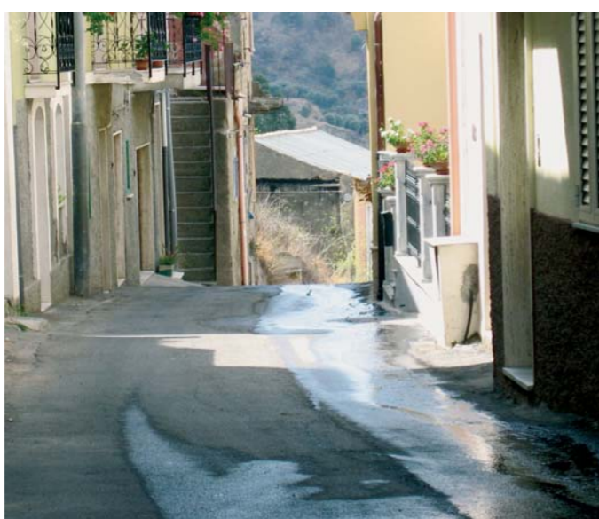
La fogna che scorre per la strada di Vito
